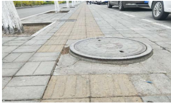
图 1-1-1 府佑小区门口、被下水道井盖隔断的盲道（图片来源：作者自摄）
